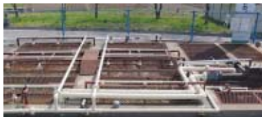
最終放流槽から夏井川(一級河川)に放流
